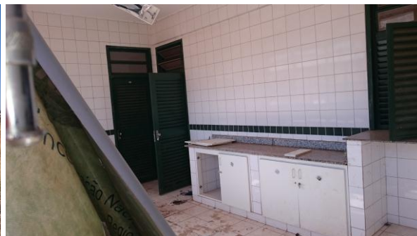
Foto 2 – Obra inacabada da Escola Técnica do Recanto das Emas – DF
